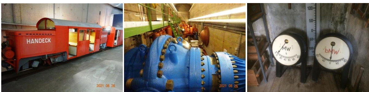
Stollenbahn, Wasserhahn und massiver in Megawatt geeichte Instrumente
